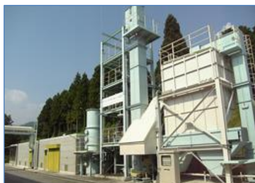
木質バイオガス発電施設
