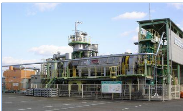
メタン発酵・発電施設
